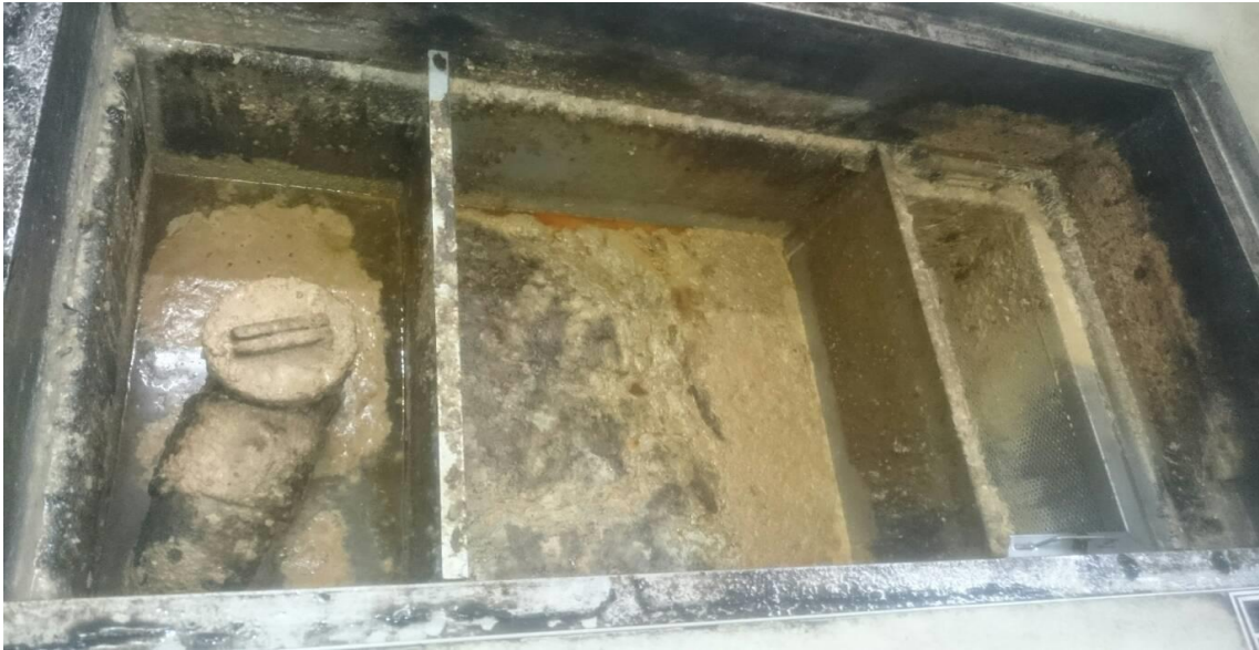
図3 二カ月間清掃していない飲食店の排水溝内部の様子
